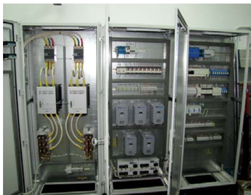
Рис. 2. Шкафы системы управления
